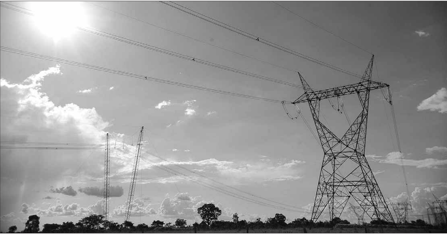
Este ano, o ONS acionou usinas termoeletricas para evitar racionamento ou apagões no horário de ponta do sistema elétrico
