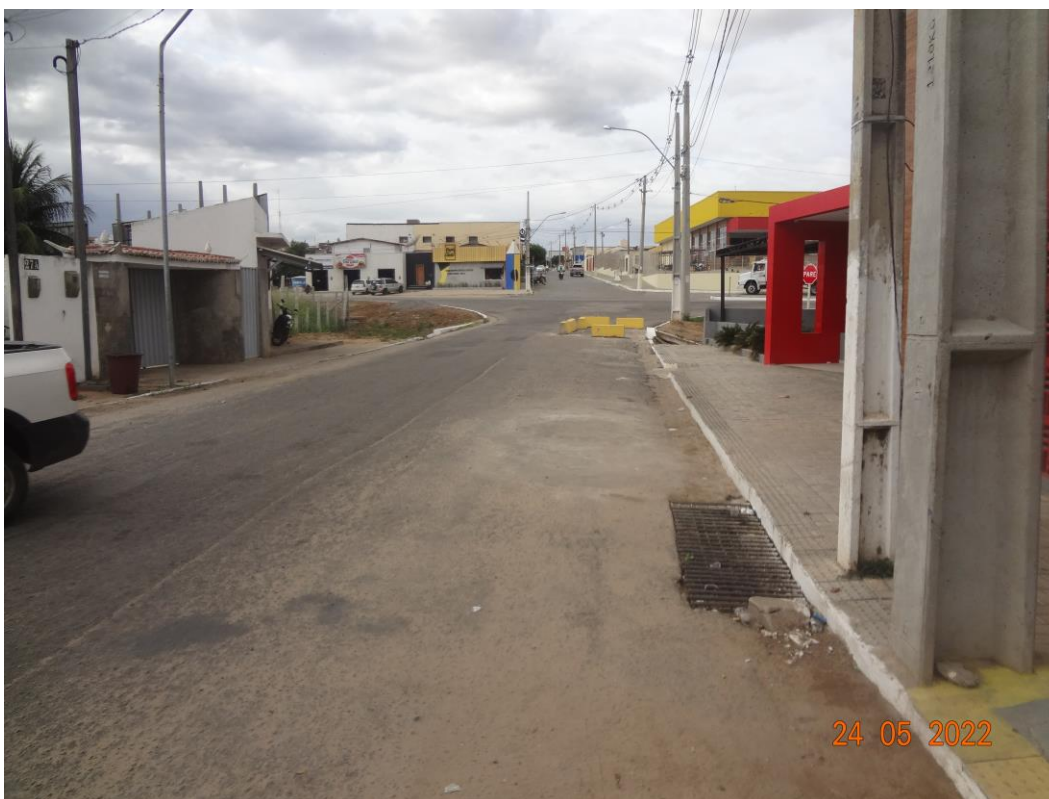
Imagem 05 – Visão geral da via, onde verifica-se uma grelha com tubulação de 150mm insuficiente para drenagem da área.
