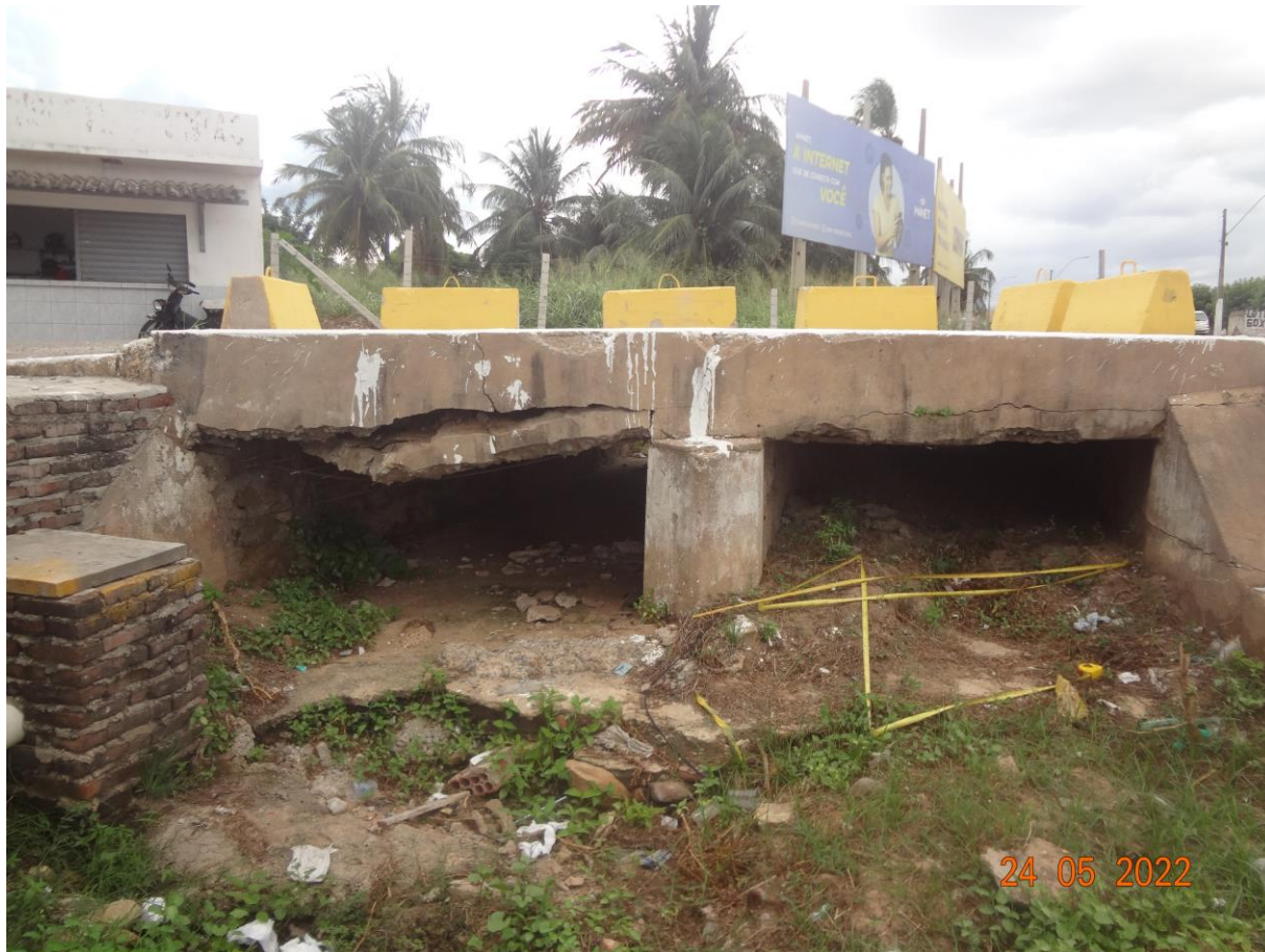
Imagem 01 – Visão externa do bueiro duplo, onde verifica-se que a estrutura (laje superior) ultrapassou seu estado limite de serviço, entrando em colapso progressivo.
