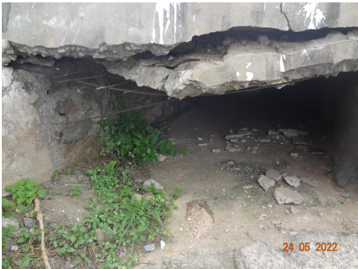
Imagem 02 – Visão focada do corpo do bueiro, onde verifica-se seccionamento de armadura inferior da laje, flecha acentuada, deslocamento de parte do concreto, e visão claramente que a estrutura ultrapassou seu estado limite de serviço, entrando em colapso progressivo.
