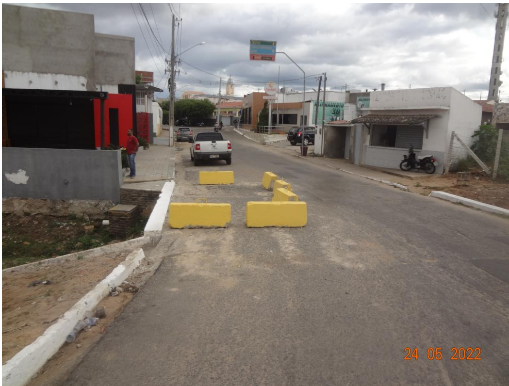
Imagem 04 – Via parcialmente interditada, em função de colapso de parte da estrutura (laje).
