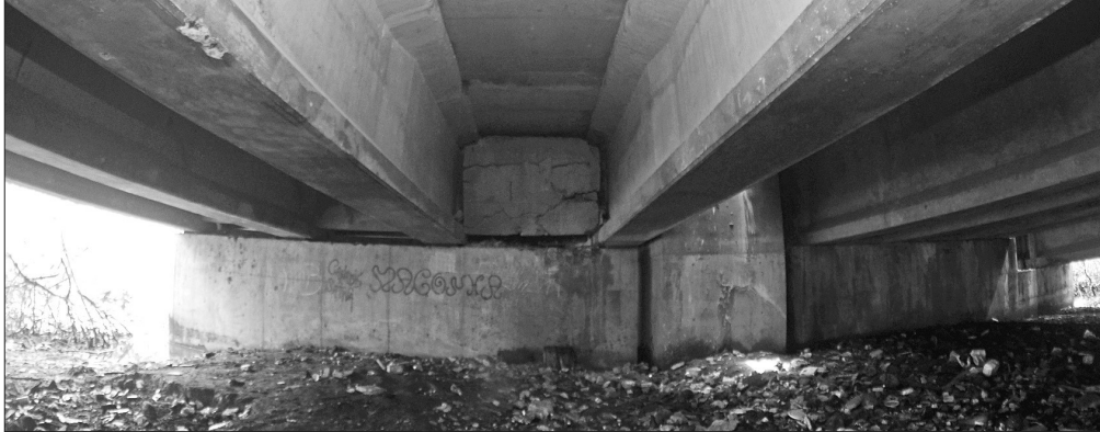
Rachaduras encontradas na estrutura da Ponte de Igapó são problema "antigo", segundo o Itep. Explosivos não conseguiram provocar danos
